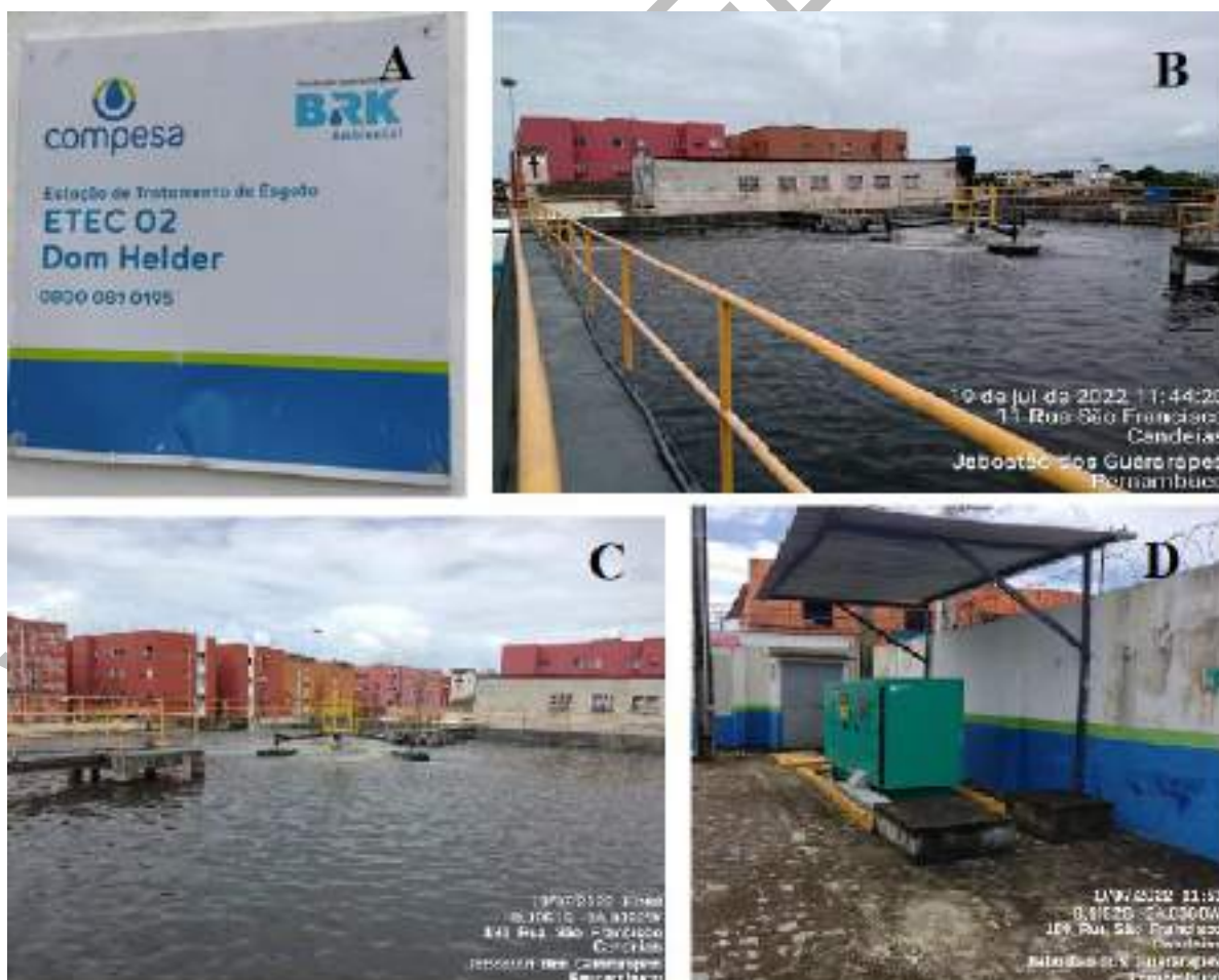
Figura 182: ETE Dom Helder. A) Placa de identificação; B) Lagoa aerada; C) Detalhe da proximidade da comunidade à ETE; D) Gerador de energia.
