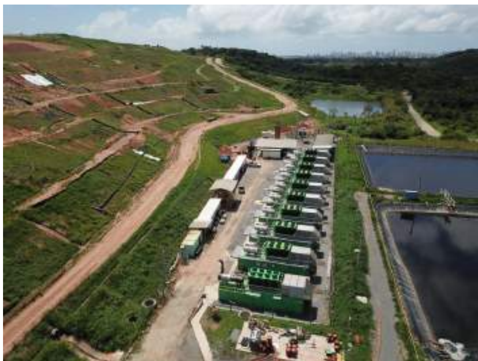
Figura 316: Geração de energia no Aterro Sanitário CTR Candeias
