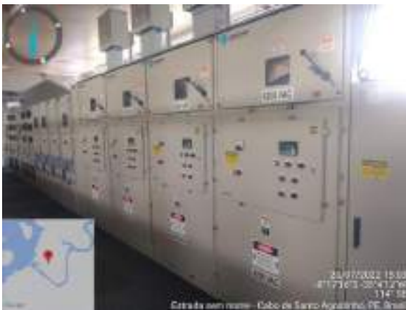
Figura 69: Quadros de comando da EEAB do Sistema de Pirapama
