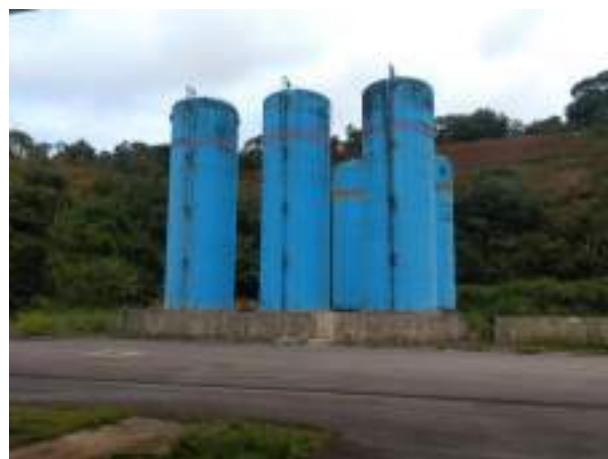
Figura 79: Tanques de armazenagem de produtos químicos da ETA Pirapama Fonte: Autores, 2022
