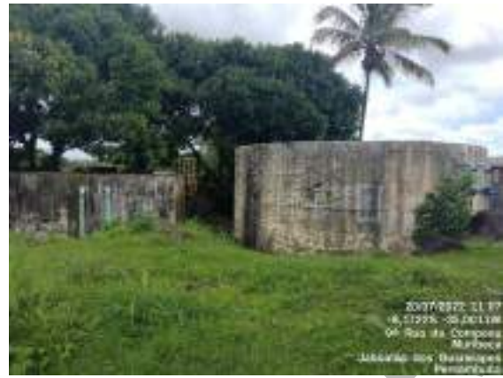
Figura 127: Reservatório apoiado pertencente ao SAA de Jaboatão dos Guararapes
