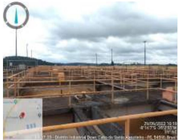
Figura 75: Floculadores da ETA Pirapama Fonte: Autores, 2022
