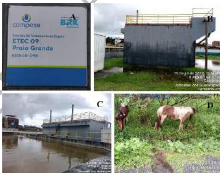
Figura 179: ETE Praia Grande. A) Placa de identificação; B) Reatores UASB; C) Lagoa aeróbia/facultativa; D) Presença de animais no terreno
