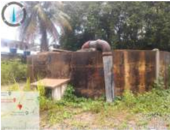
Figura 126: Reservatório apoiado pertencente ao SAA de Jaboatão dos Guararapes
