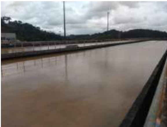
Figura 76: Decantadores da ETA Pirapama Fonte: Autores, 2022
