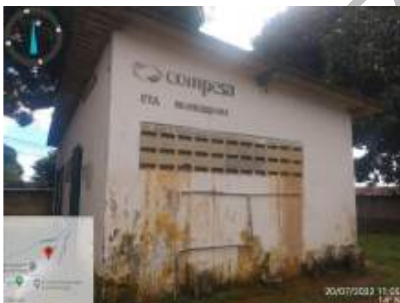
Figura 119: Casa de máquinas da ETA Muribequinha
