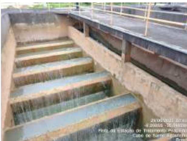
Figura 80: Filtros da ETA Pirapama
