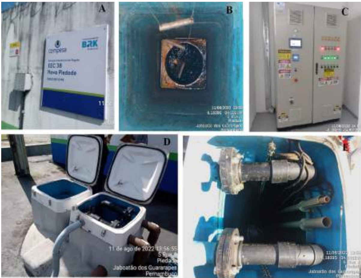
Figura 167: EEC 38 - Nova piedade. A) Placa de Identificação; B) Poço com sistema de retenção de sólidos grosseiros – Peneiramento; C) Painel de Controle presente em abrigo D) à esquerda poço de retenção de sólidos grosseiros com peneira, e a direita poço de sucção.
