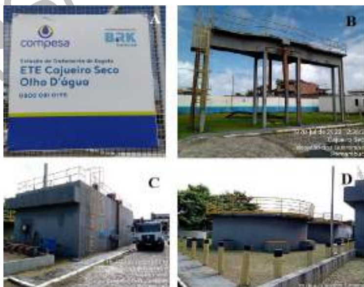
Figura 184: ETE Cajueiro seco. A) Placa de identificação; B) Tratamento preliminar; C) Reatores UASB-vista lateral; D) Filtros aeróbios.
