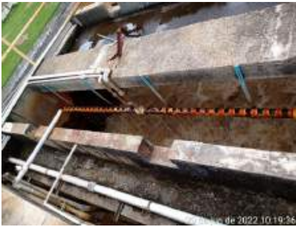
Figura 74: Dosador de sulfato de alumínio da ETA Pirapama Fonte: Autores, 2022
