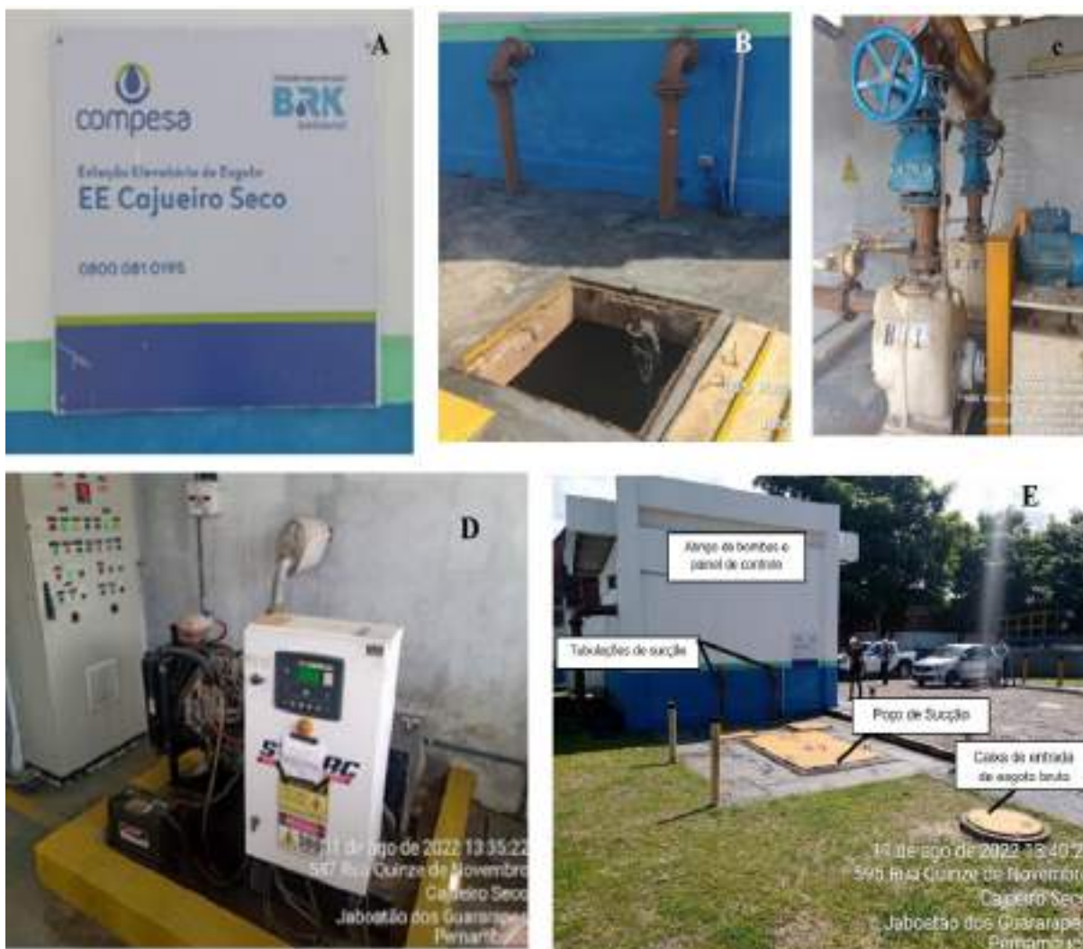
Figura 160: EEC Cajueiro Seco. A) Placa de Identificação; B) Poços de sucção e tubulação de sucção; C) conjunto motor-bomba D) Painel de controle; E) Visão geral da elevatória.
