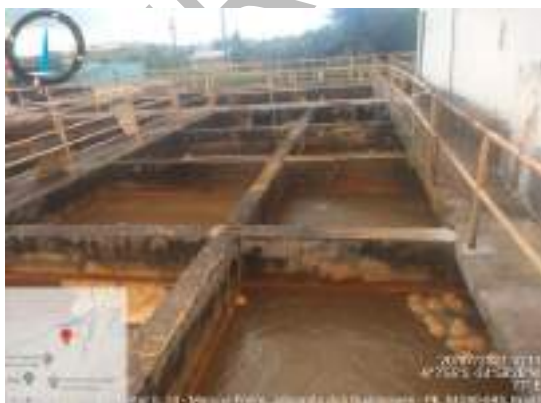
Figura 105: Flocculadores da ETA convencional do Sistema Marcos Freire
