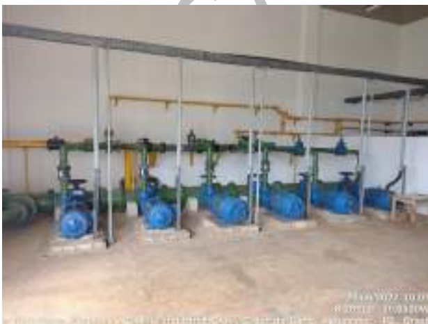
Figura 78: Conjuntos motor-bomba ETA Pirapama Fonte: Autores, 2022
