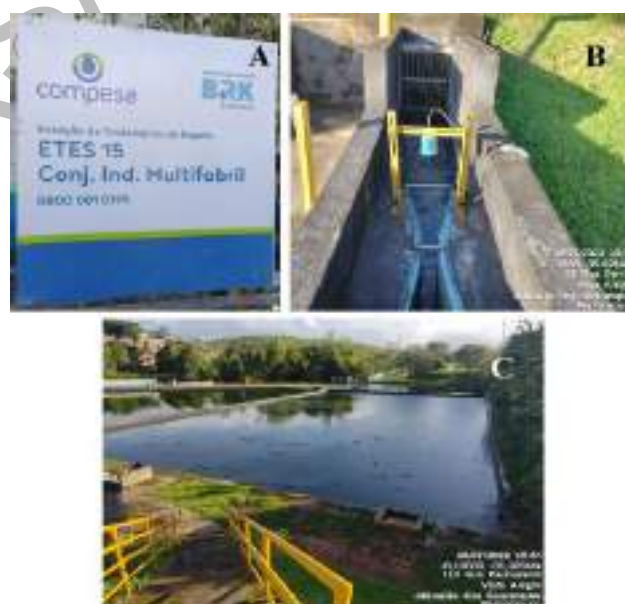
Figura 188: ETE Multifabril A) placa de identificação. B) tratamento preliminar C) série de lagoas de estabilização
