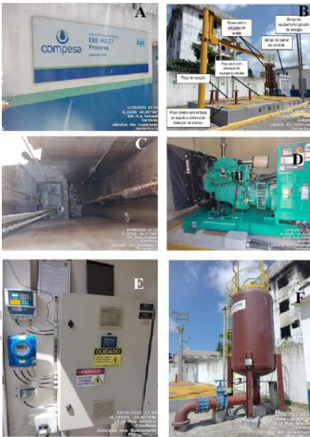
Figura 172: EEC 40.07 – Prazeres. A) Placa de Identificação; B) Visão Geral da EE; C) Poço com sistema de retenção de sólidos grosseiros – Cesto D) Gerador de energia; E) Painel de controle; F) Reservatórios antigolpe de aríete.
