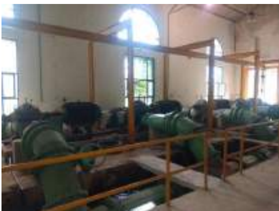
Figura 100: Conjuntos motor-bomba da ETA Gurjaú.
