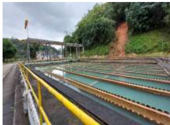
Figura 97: Filtros da ETA Gurjaú
