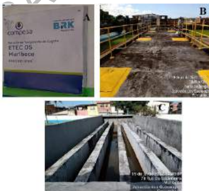
Figura 186: ETE Muribeca. A) placa de identificação. B) Tanque Imhoff – vista superior; C) Tanque de desinfecção
