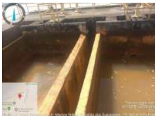
Figura 106: Decantadores da ETA convencional do Sistema Marcos Freire
