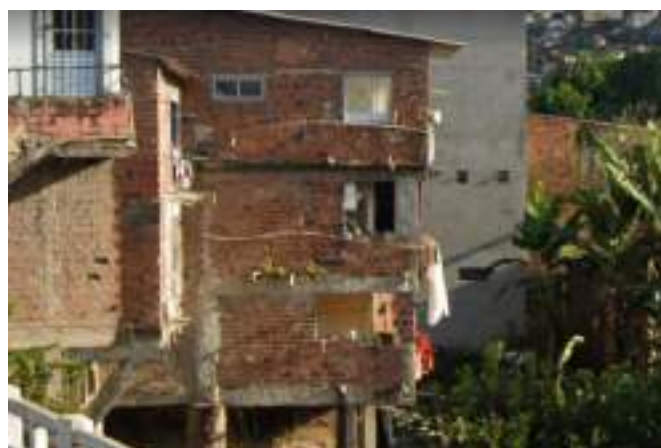
Figura 241: Detalhe das ligações clandestinas encontradas no Rio Jaboatão – Centro
