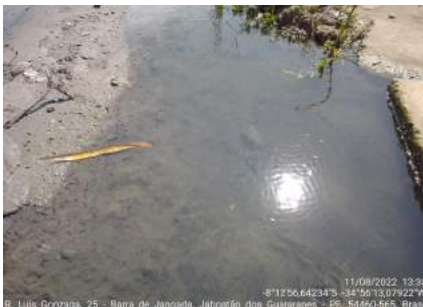
Figura 238: Existência de vazamento do sistema de esgoto encontrada na rua
