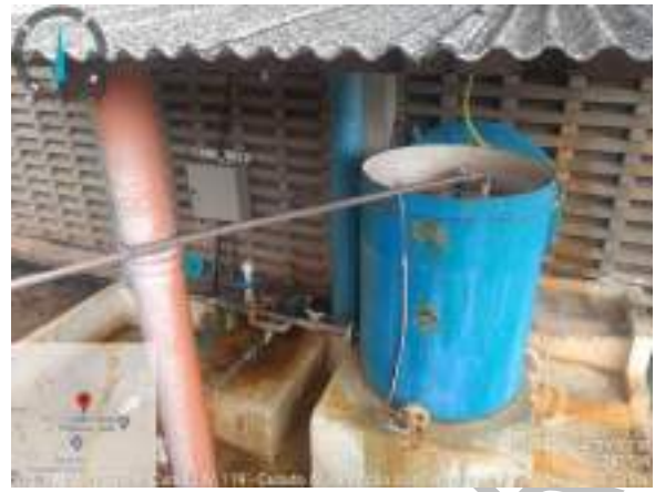
Figura 87: Tanque de cloro da ETA Castelo Branco
