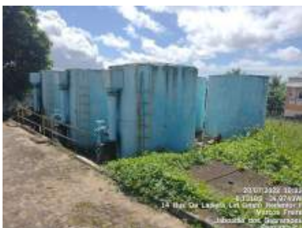
Figura 109: Filtros da ETA Compacta do Sistema Marcos Freire
