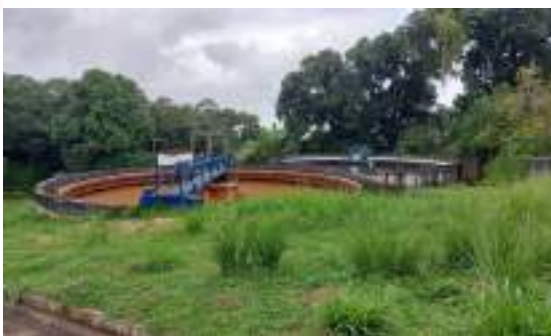
Figura 98: Adensador de lodo da ETA Gurjaú
