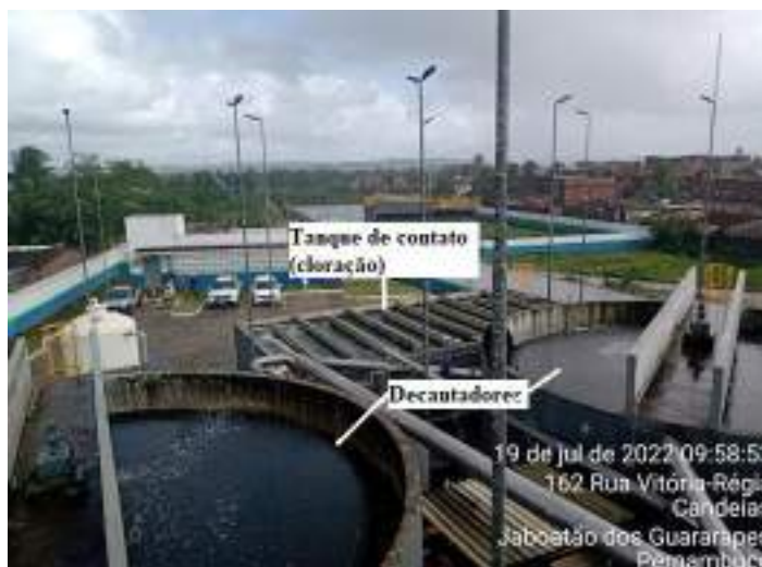
Figura 177: ETE Prazeres: em destaque o tanque de contato e os decantadores.
