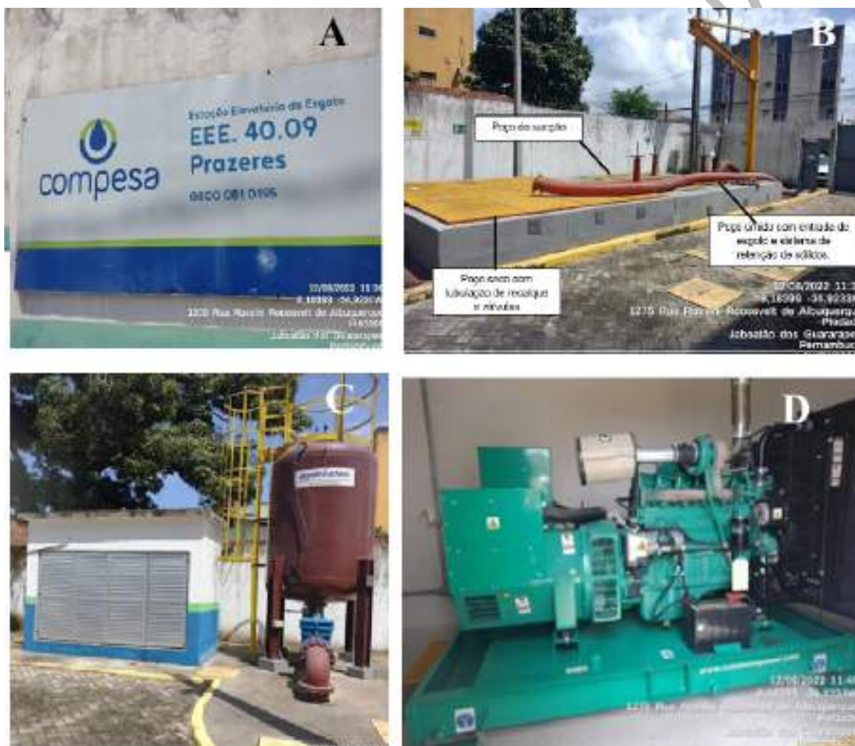
Figura 171: EEE 40.09 – Prazeres. A) Placa de Identificação; B) Visão Geral da EE; C) abrigo do painel de controle e reservatórios antigolpe de aríete; D) gerador de energia.
