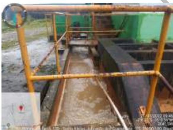
Figura 111: Entrada da água bruta da ETA Manoel de Sena
