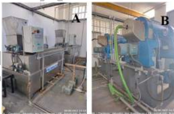
Figura 178: ETE Prazeres: adensadores de lodo
