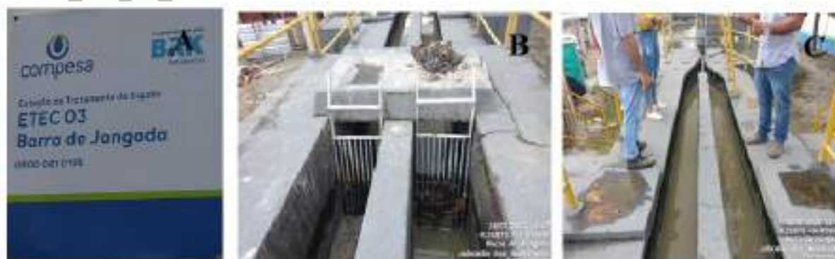
Figura 180: ETE Barra de Jangada. A) Placa de identificação; B) Gradeamento; C) Caixa de areia.
