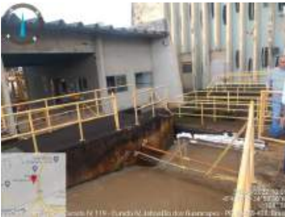
Figura 88: Dosador de sulfato da ETA Castelo Branco
