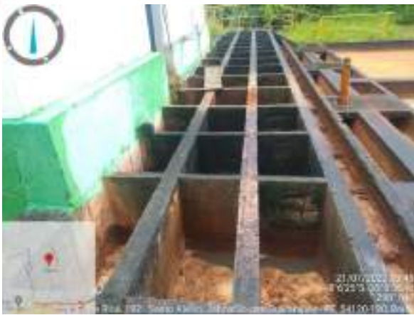
Figura 113: Floculadores da ETA Manoel de Sena
