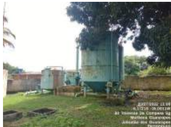
Figura 122: Filtros da ETA Muribequinha
