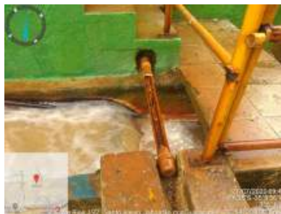
Figura 112: Dosador de sulfato da ETA Manoel de Sena
