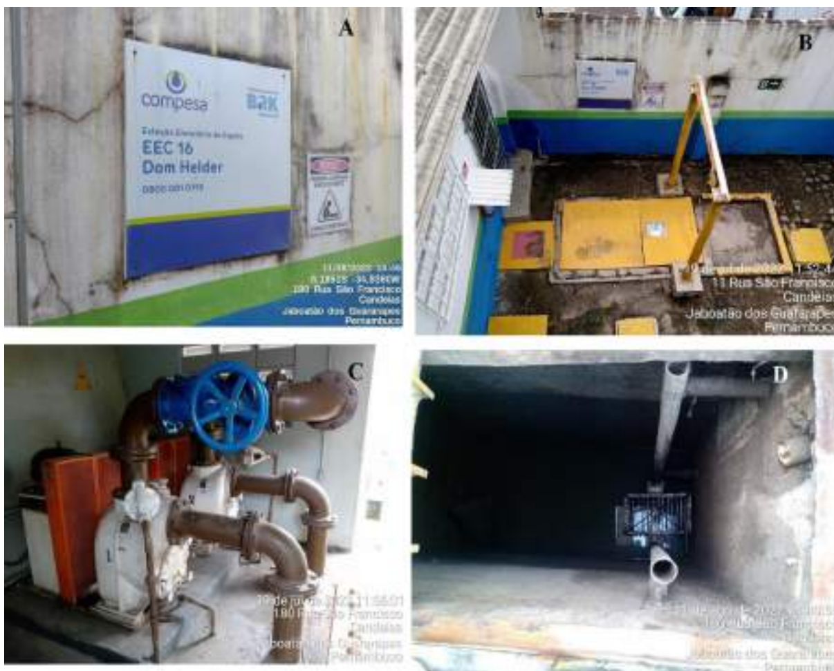
Figura 162: EEC 16 Dom Helder. A) Placa de Identificação; B) Visão geral da elevatória; C) Conjuntos motor-bomba autoescorvantes D) Poço com retenção de sólidos grosseiros – cesto.
