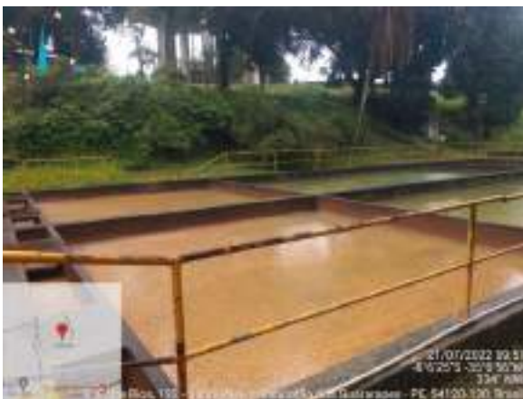
Figura 115: Decantadores da ETA Manoel de Sena
