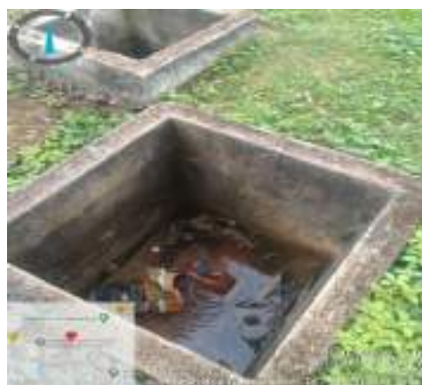
Figura 120: Caixa de registro da ETA Muribequinha
