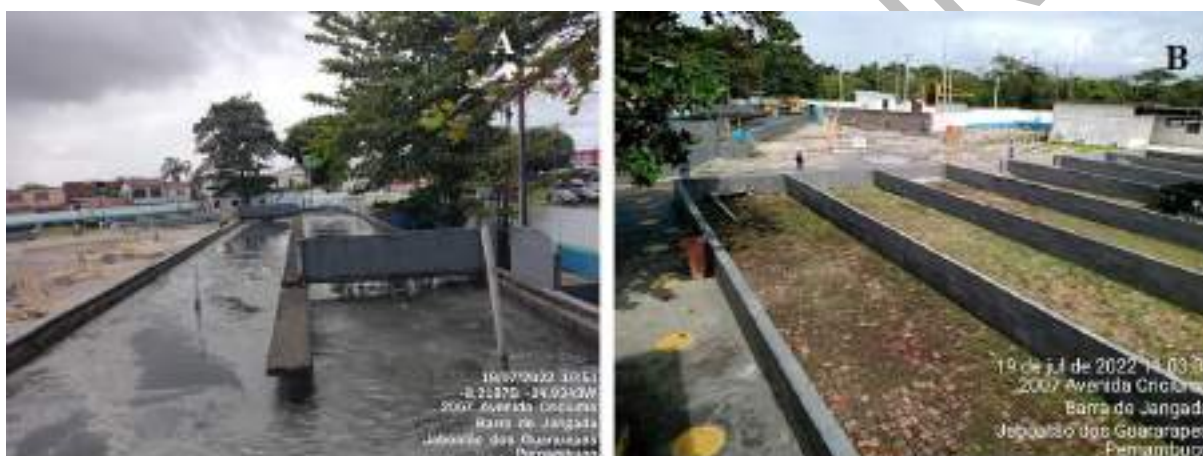
Figura 181: ETE Barra de Jangada. A) Vala de oxidação; B) Leitos de secagem de lodo.
