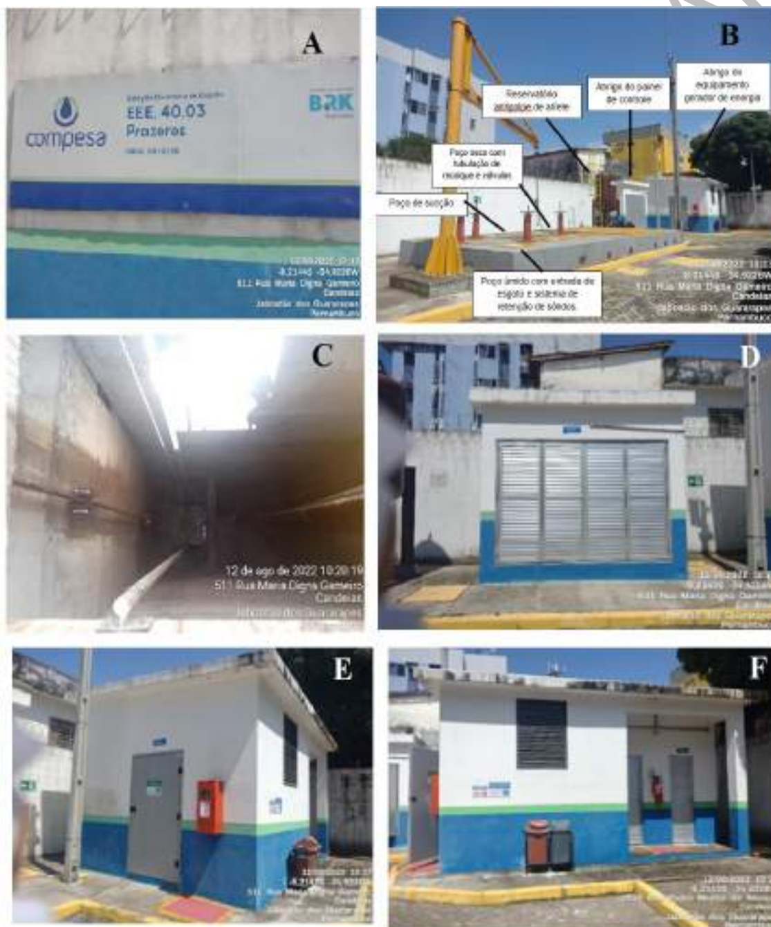
Figura 170: EEE 40.05 – Prazeres A) Placa de Identificação; B) Visão Geral; C) Poço) Abrigo do painel de controle; E) abrigo do gerador de energia; F) estrutura de apoio com banheiros.
