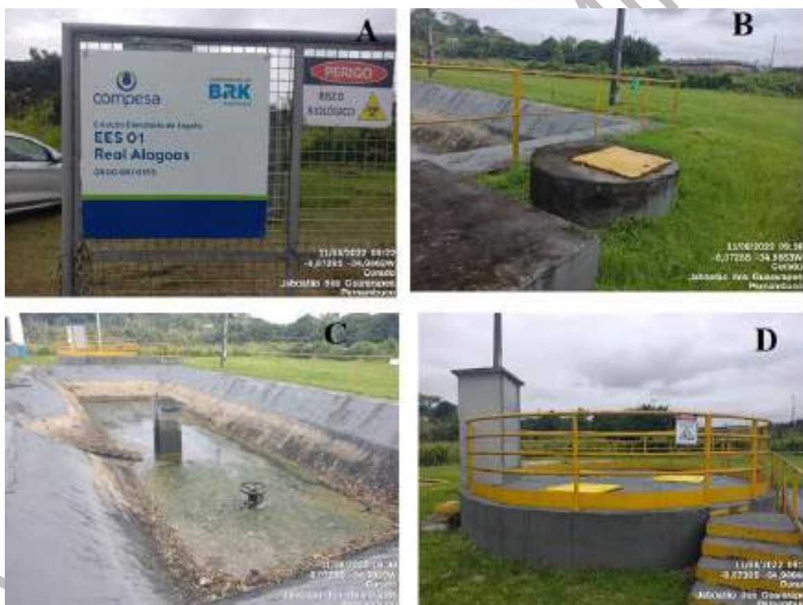
Figura 173: EES 01 - Real Alagoas. A) Placa de Identificação; B) Caixa de chegada dos efluentes; C) Unidade de desarenador e medição de vazão (calha Parshall) da EE, que se encontrava submersa por problemas em bomba de sucção D) Poços de sucção – vista lateral.
