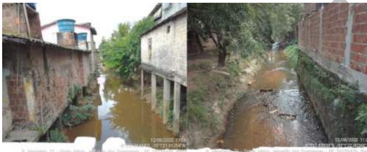
Figura 257: Identificação de ligações clandestinas encontradas no Canal Beira Rio
