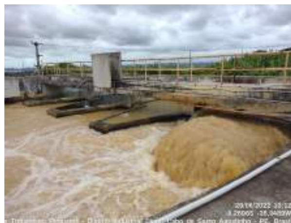
Figura 73: Chegada de água bruta (caixa de reunião) da ETA Pirapama
