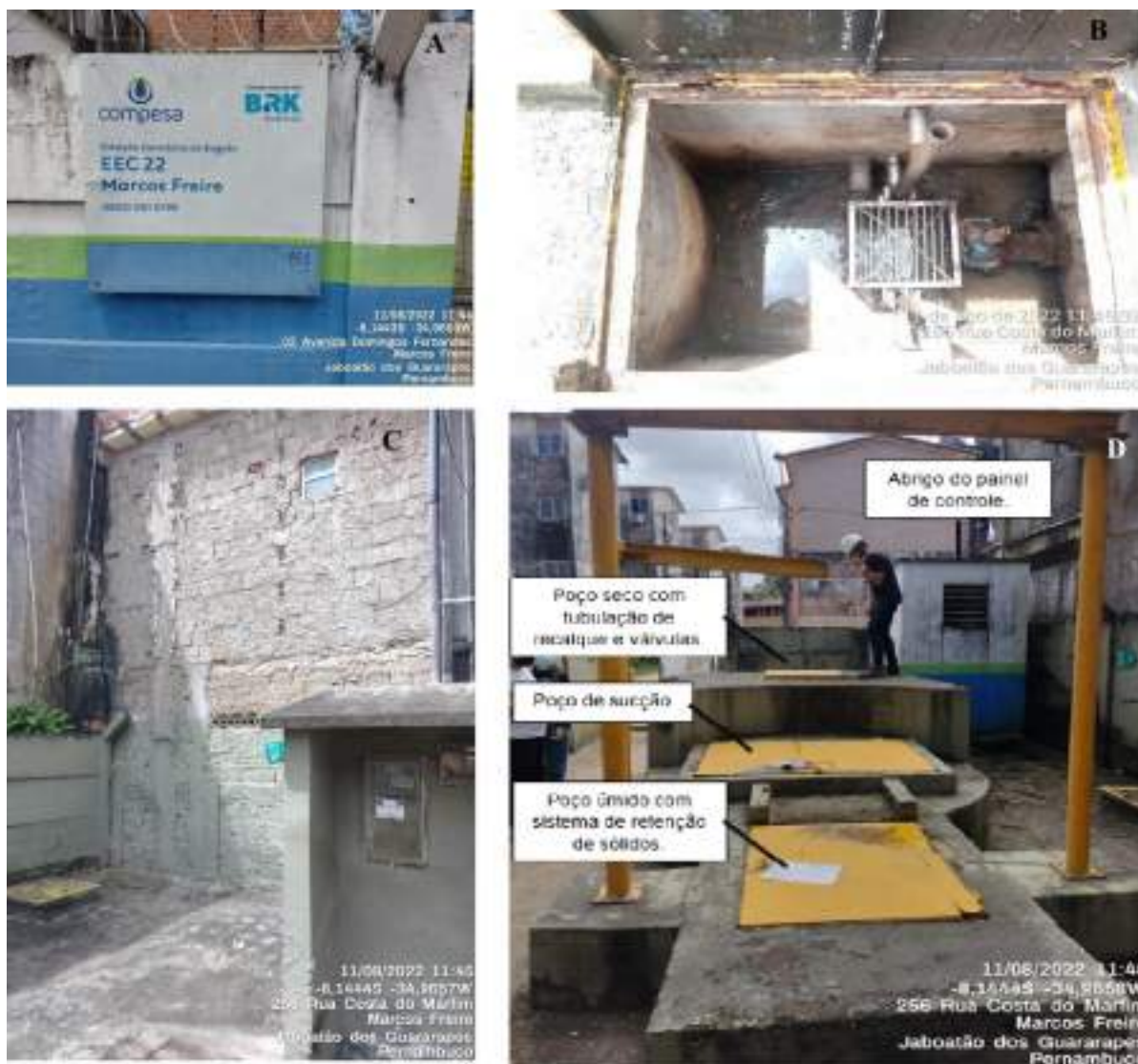
Figura 165: EEC 22 - Marcos Freire. A) Placa de Identificação; B) Poço com sistema de retenção de sólidos grosseiros – Cesto; C) Muro da EE utilizado para construção de habitação vizinha; D) Visão geral da elevatória
