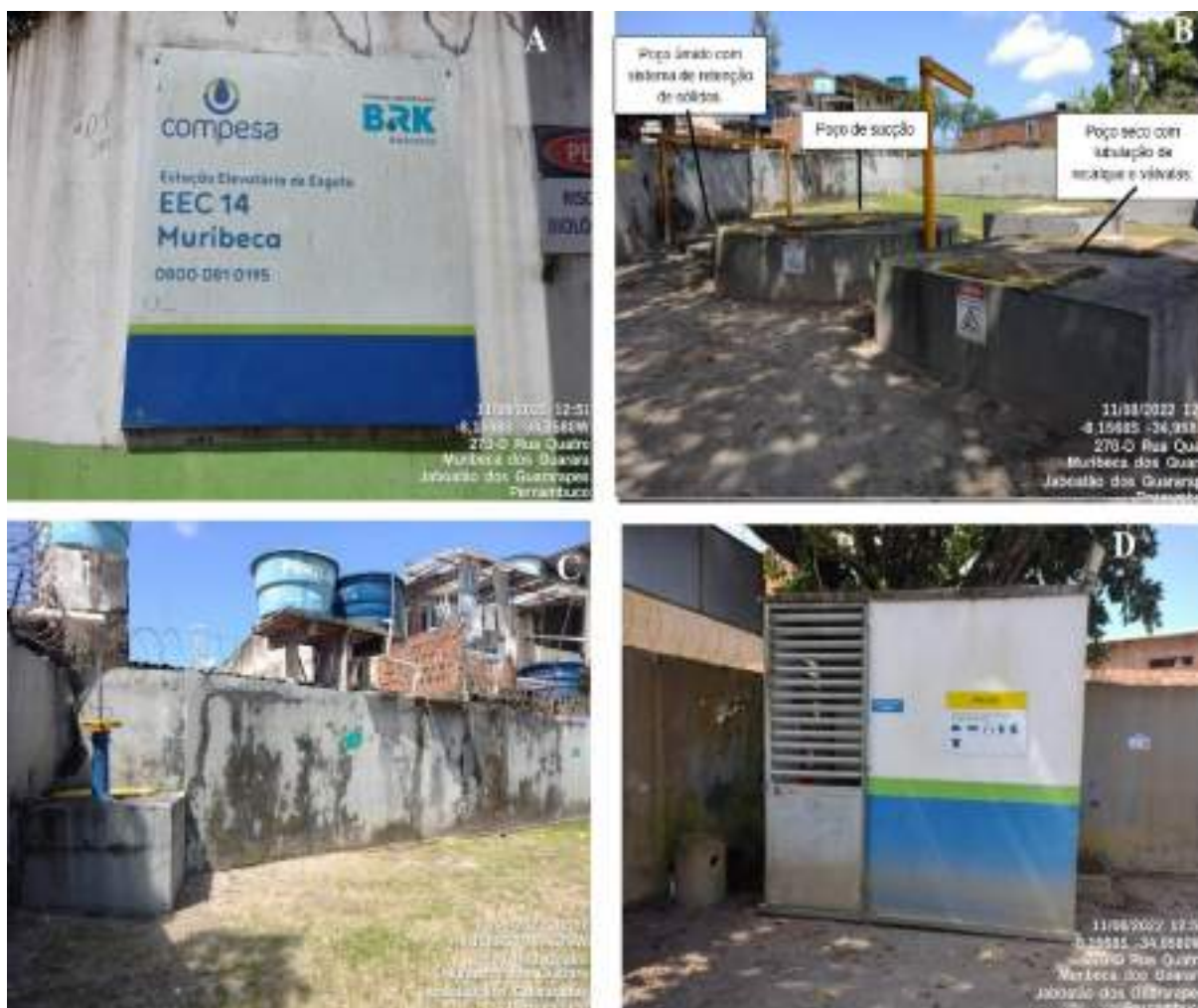
Figura 166: EEC 14-Muribeca. A) Placa de Identificação; B) Visão geral da elevatória; C) à esquerda, caixa com registro de entrada de efluente na EE, e na direita, presença de habitações vizinhas construídas utilizando o muro da EE. D) Abrigo do painel de controle
