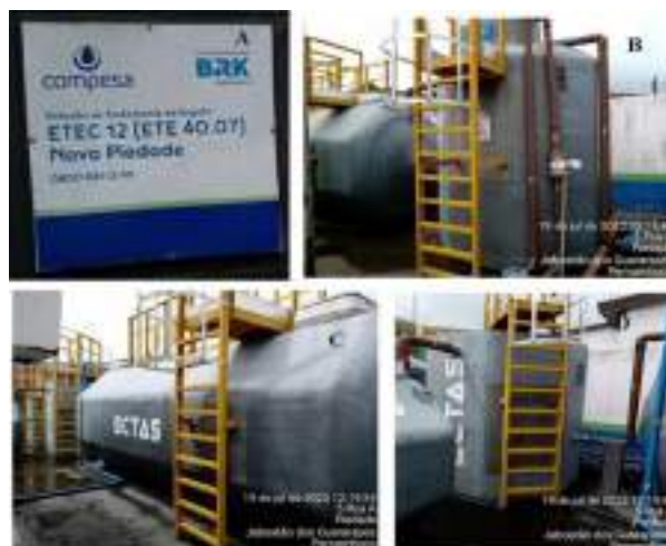
Figura 183: A) Placa de identificação; B) Tanque retentor de sólidos; C) Reator filtro de membrana aerado (MBBR); D) Tanque de decantação secundária;
