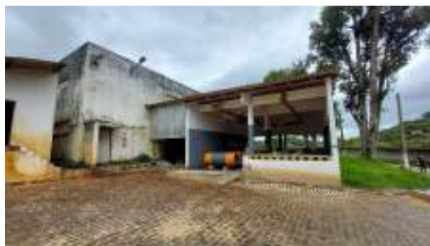
Figura 99: Cilindros de cloro da ETA Gurjaú
