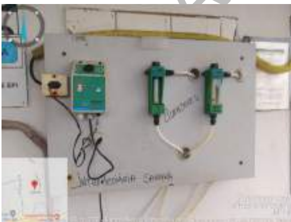
Figura 117: Cloradores da ETA Manoel de Sena
