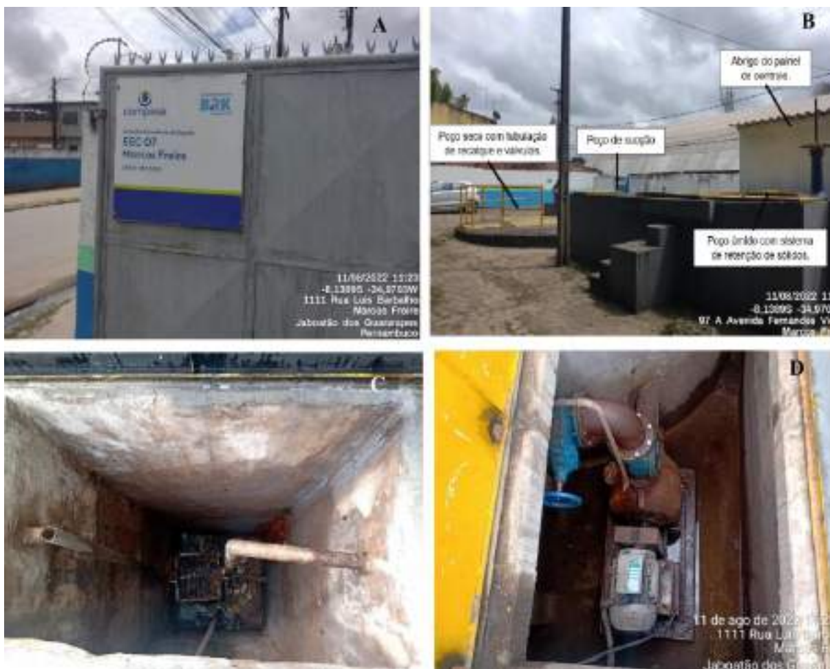
Figura 164: EEC 07 - Marcos Freire. A) Placa de Identificação; B) Visão geral da elevatória; C) Poço com sistema de retenção de sólidos grosseiros – Cesto D) Poço seco com bombas autoescorvantes, tubulação de recalque e válvulas.
