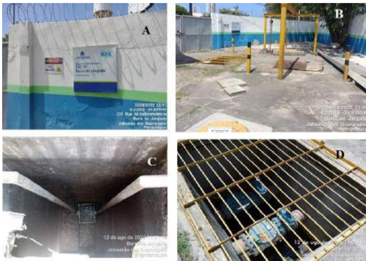
Figura 158: EEC-10. A) Placa de identificação; B) Visão Geral da Elevatória; C) Poço com sistema de retenção de sólidos grosseiros – Gradeamento; D) Poços seco com tubulação de recalque e válvulas.
