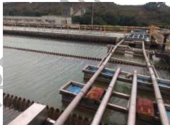
Figura 77: Decantadores da ETA Pirapama Fonte: Autores, 2022
