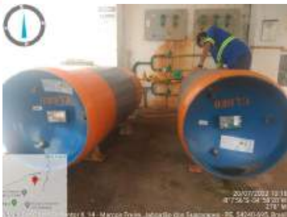
Figura 107: Tanques de cloro da ETA Marcos Freire
