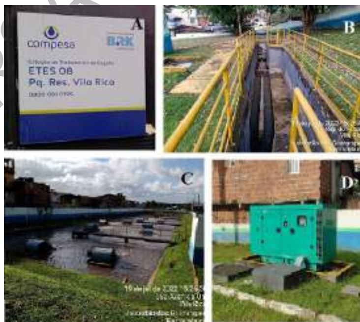
Figura 187: ETE Res. Vila Rica. A) placa de identificação. B) tratamento preliminar C) Lagoa aerada; D) gerador de energia.
