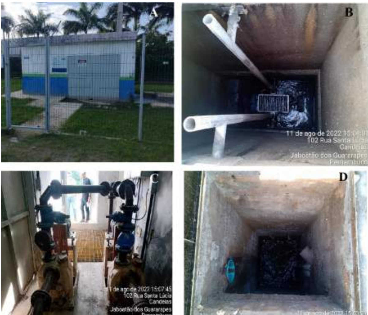
Figura 168: EEC 29 - Praia Grande A) Abrigo do conjunto motor-bomba; B) Poço com sistema de retenção de sólidos grosseiros – Cesto.; C) Poços de sucção e conjuntos motor-bomba autoescorvantes, situados entro do abrigo; D) Caixa de entrada de efluente bruto.
