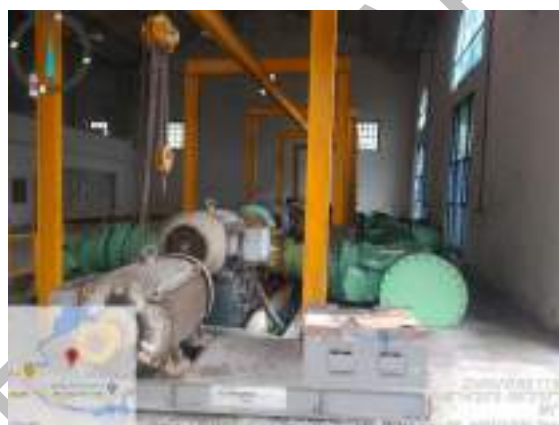
Figura 101: Conjuntos motor-bomba da ETA Gurjaú.
