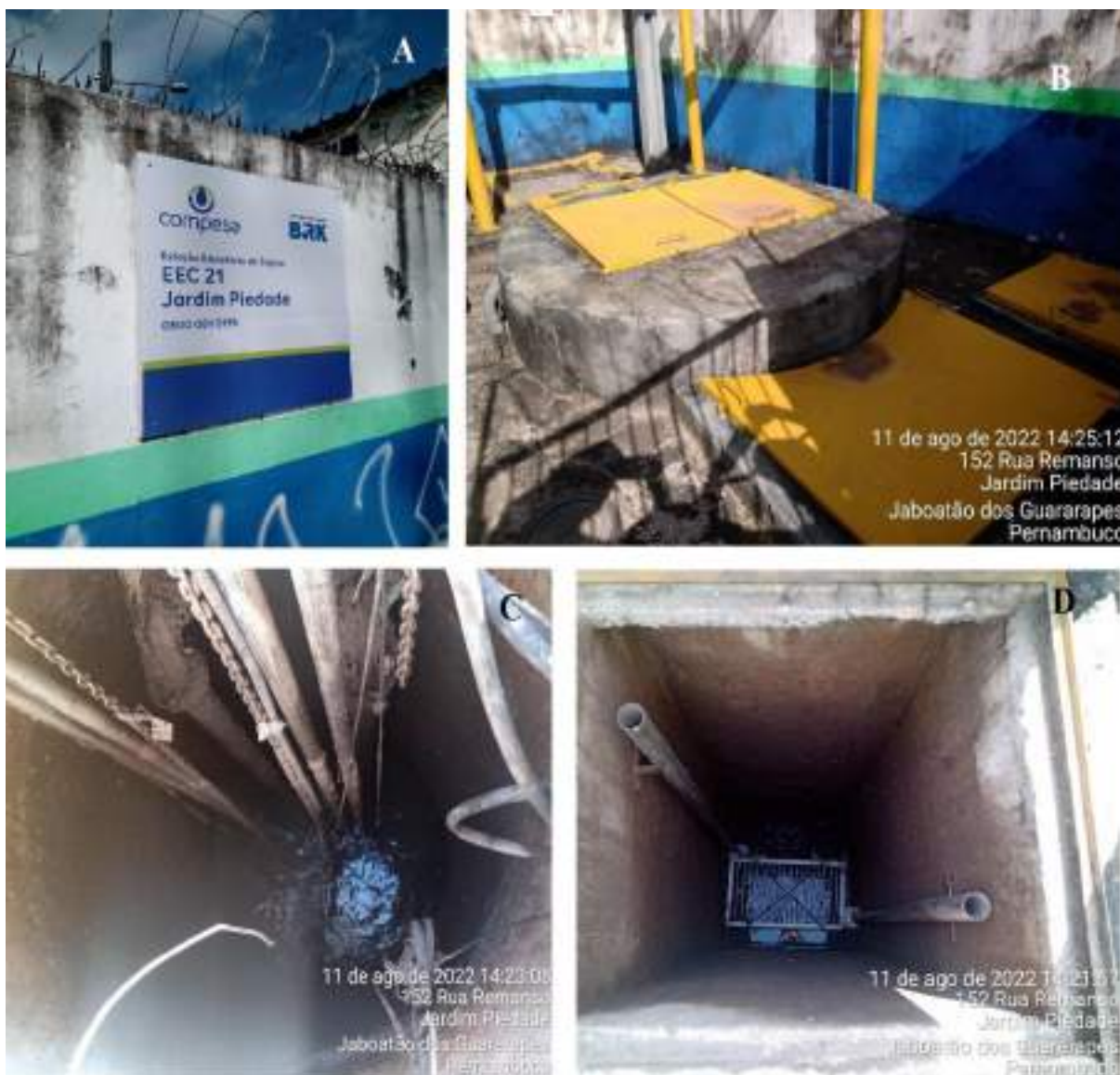
Figura 163: EEC 21 Jardim Piedade. A) Placa de Identificação; B) Visão geral da elevatória; C) poço de sucção autoescorvantes D) Poço com retenção de sólidos grosseiros – cesto.
