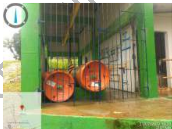
Figura 116: Tanques de cloro da ETA Manoel de Sena
