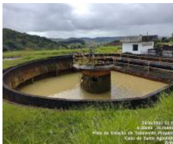
Figura 81: Adensador de lodo da ETA Pirapama
