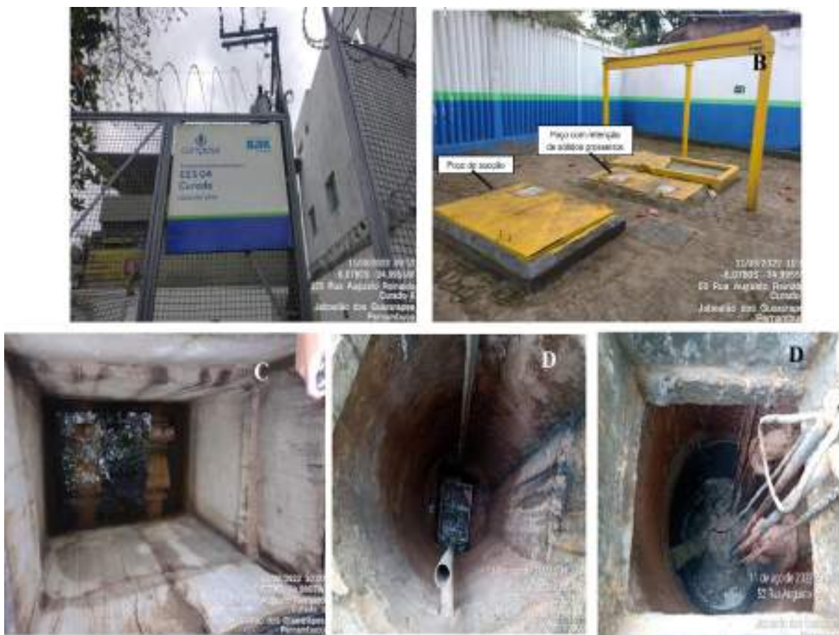
Figura 161: EES 04 Curado. A) Placa de Identificação; B) Visão geral da elevatória; C) Poço de recalque e válvulas – cheio de água pluvial D) Poço com retenção de sólidos grosseiros – cesto; E) poço de sucção.
