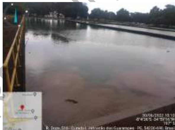
Figura 89: Decantadores da ETA Castelo Branco
