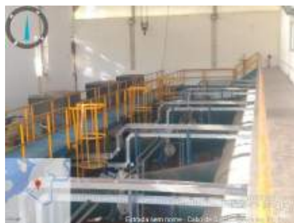
Figura 70: Conjuntos motor-bomba da EEAB da Barragem de Pirapama.
