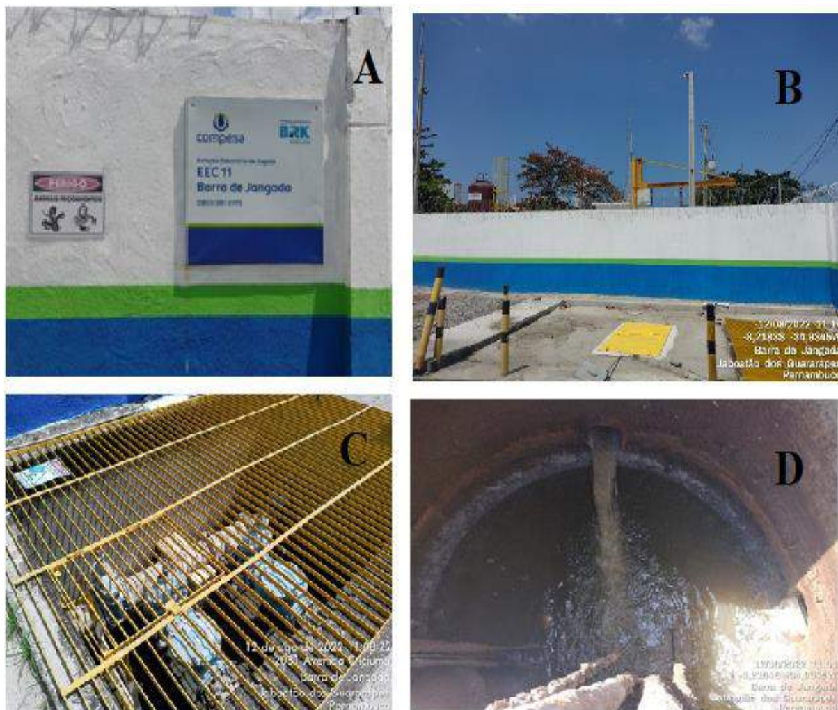
Figura 159: EEC 11. A) Placa de Identificação; B) Visão geral da elevatória; C) poço seco com tubulações de recalque e válvulas. D) Poço de sucção.
