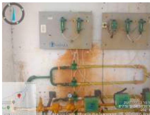
Figura 108: Comandos para controle de aplicação de cloro da ETA Marcos Freire
